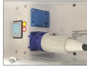
Stromzähler im Schaltkasten
